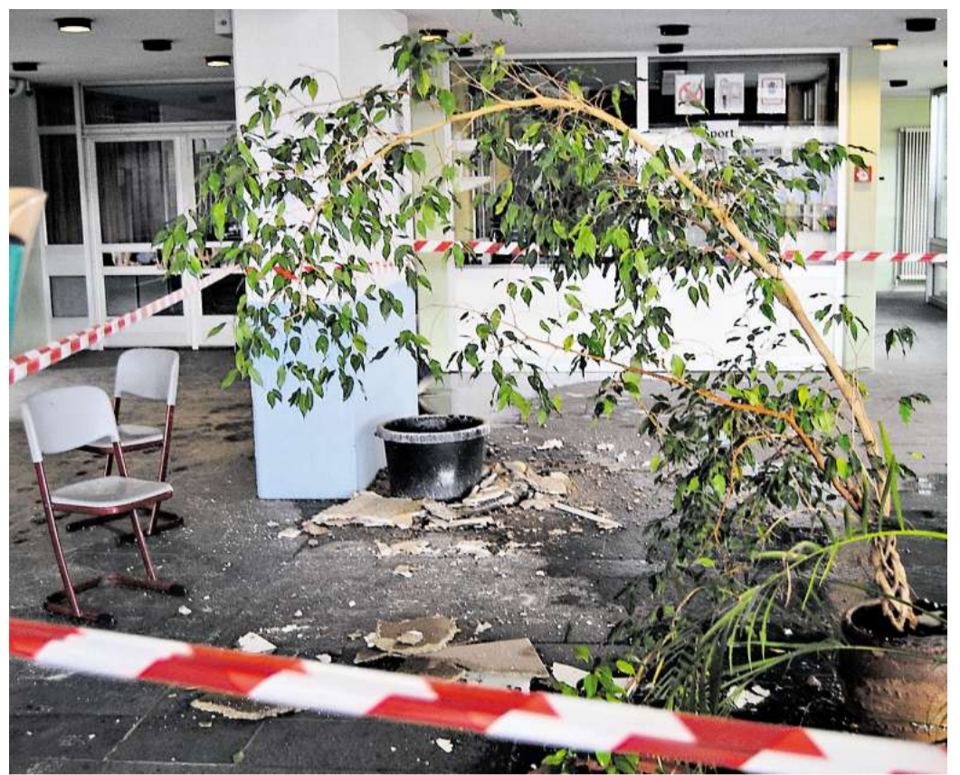
Katastrophale Zustände: Durch die starken Regenfälle stürzten Teile der Deckenverkleidung in die alte Aula der früheren Sassenburg-Schule. Chavier
